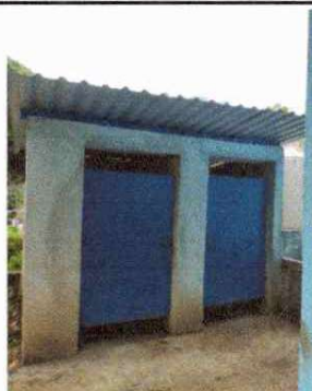
Foto1: Servicios Sanitarios y sus Accesorios
